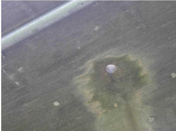
Figura 8. Manchas de humedad en losas de veredas por desagües sin goterón.
