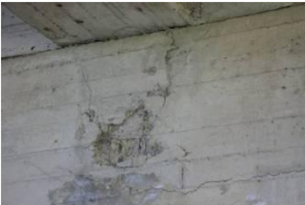
Figura 12. Fisuras en estribo
