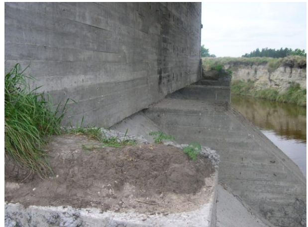
Figura 11. Presencia de material orgánico en cabezas de pilotes.
