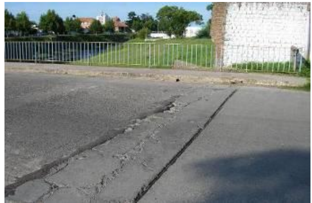
Figura 13. Fisuras sobre tablero. Falta de mantenimiento junta
