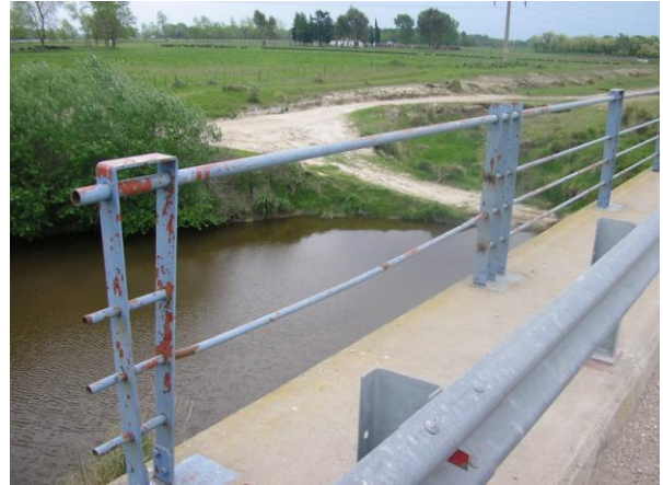
Figura 9. Falta de elementos en barandas peatonales de ambos lados.
