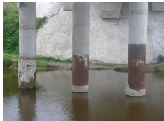
Figura 7. Restos de hormigón y suelo adosados a camisas de columnas que presentan incipiente corrosión
