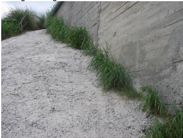
Figura 10. Crecimiento de vegetación entre muro de contención y protección
