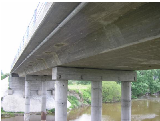
Figura 6. Manchas de humedad por desagües sin goterón.
