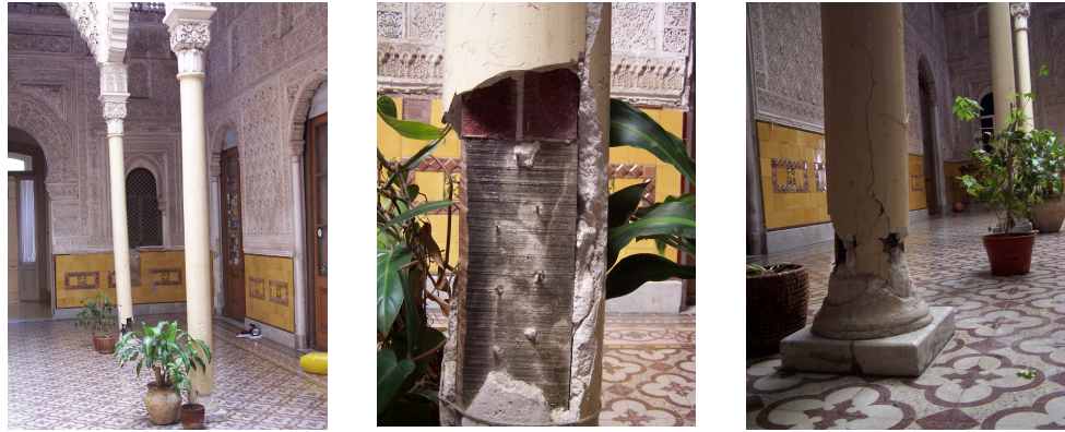
Se observa el desplazamiento de la columna 1 y roturas en el sector inferior de las columnas.
