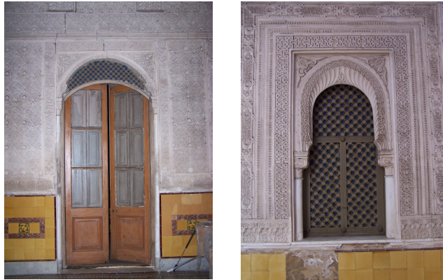
Vista de vanos con un revestimiento superior en yeso. Se observa la falta de cerámicos.
