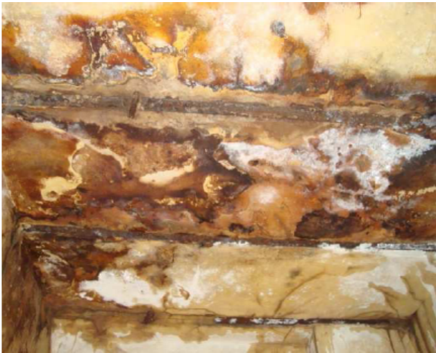
Fotografía 9 - Estado de la bovedilla
