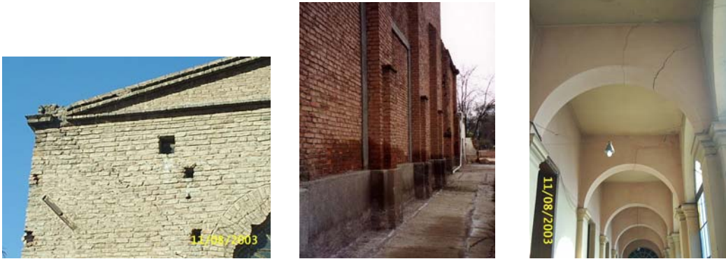
Figura 1: Daños en mampostería por sismo en paredes y arcos y presencia de humedad por pérdidas en desagües [2].
