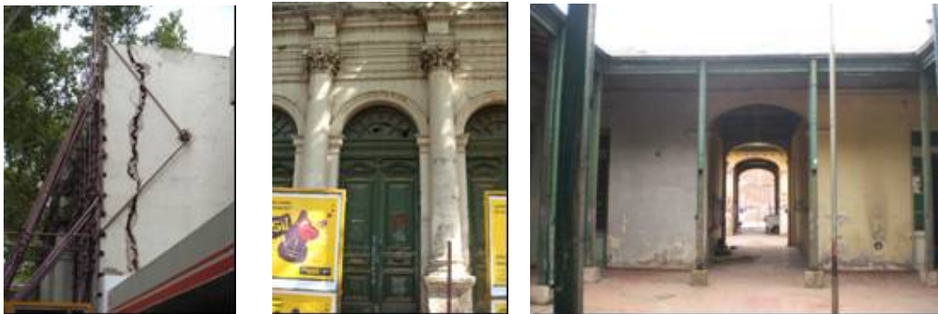
Figura 2: Estado actual de la fachada y del interior del edificio escolar
