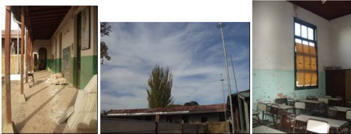
Figura 6: Estado actual de la escuela Antonio Zinny
