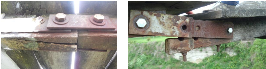
Figura 10: Roturas en zona de articulación.
