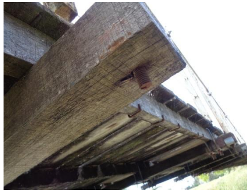
Figura 17: Pérdida de medio de unión a la vigueta
