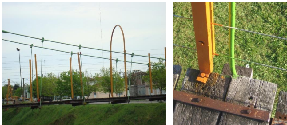
Figura 18: Péndolas inclinadas y dobladas
