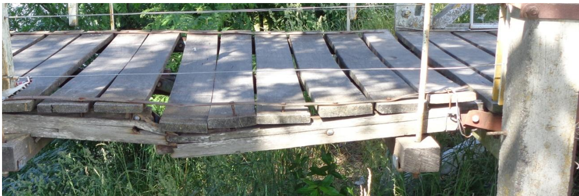
Figura 22: Daño en el larguero
