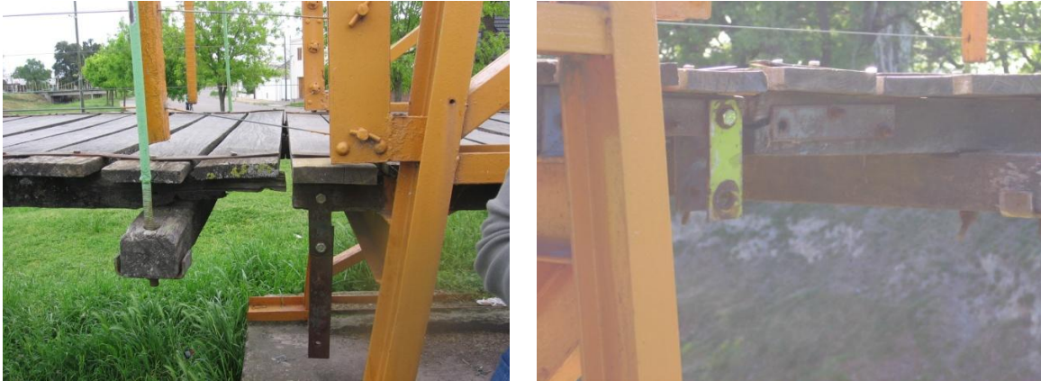
Figura 19: Pérdida de la articulación
