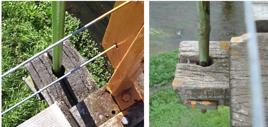
Figura 13: Deterioros en la unión de la péndola con la vigueta
