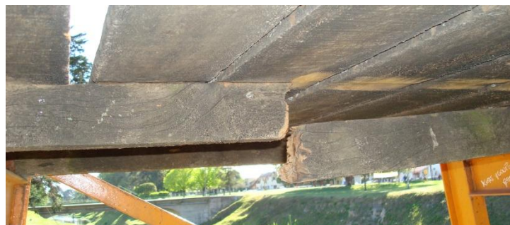
Figura 11: Rotura de larguero
