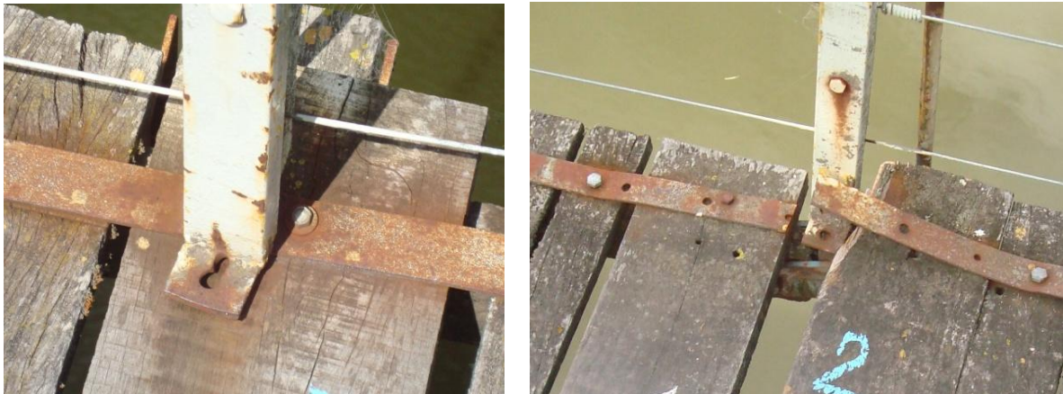
Figura 20: Pérdida del medio de unión al tablero de arcos y flejes
