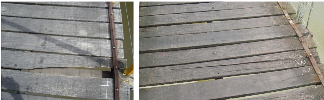
Figura 9: Daños en tablas
