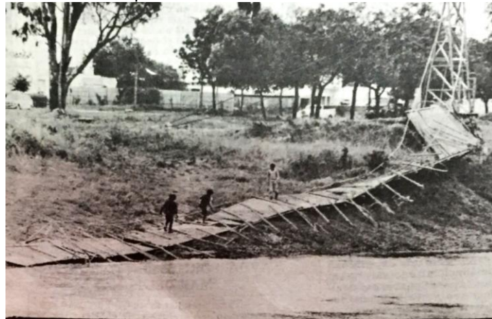
Figura 3: Puente destruido por la inundación, año 1985
