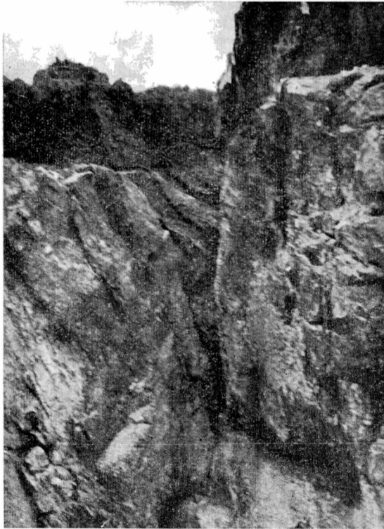
Foto Nº 2. — Sector del techo de "La Ventana" fuertemente diaclasado.
