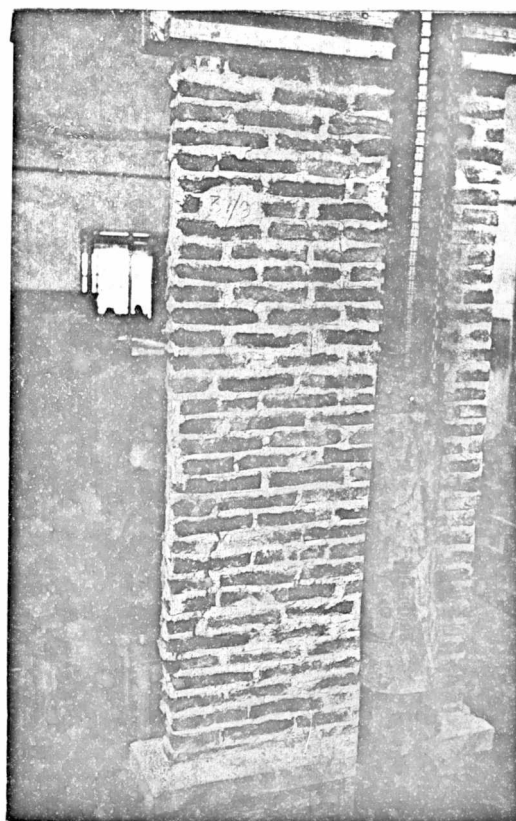
Fig. 21.- Detalle de rotura, muro de ladrillos cerámicos comunes.
