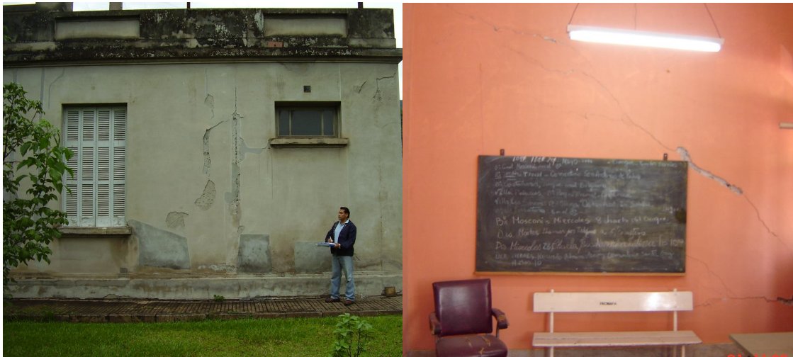
Figura 11. Fisuras en parte de la fachada oeste y en muro interior
