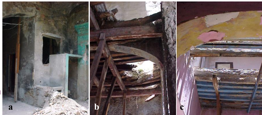
Figura 7 – Diagnóstico de deterioro
