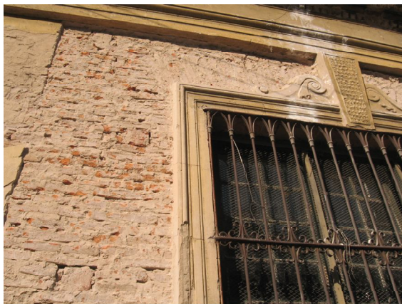
Foto 21. Desprendimiento de revoques.
