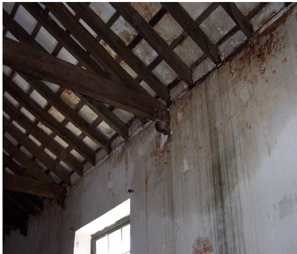
Fotografía 13. Sala II. Humedad proveniente de la concha.
