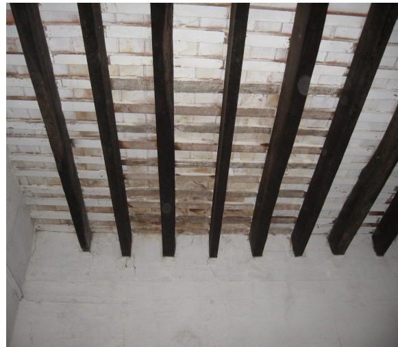
Fotografía 14. Sala I. Humedad proveniente de la Sala II.
