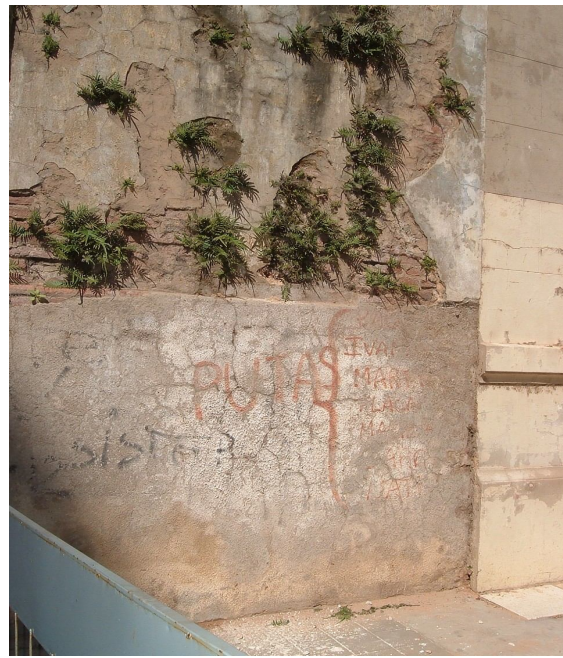
Fotografía 20. Invasión biótica en la fachada.
