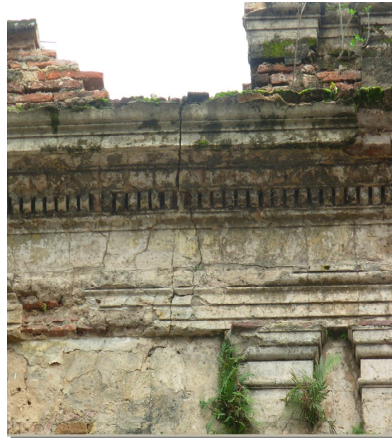
Fotografía 16. Lesiones en el pretil y la cornisa.
