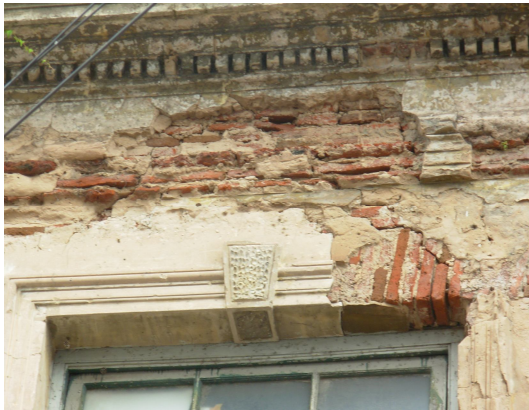
Fotografía 17. Degradación de revocos.
