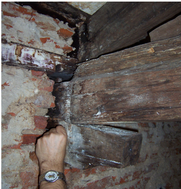
Fotografía 11. Pares y nudillos en estado de putrefacción.
