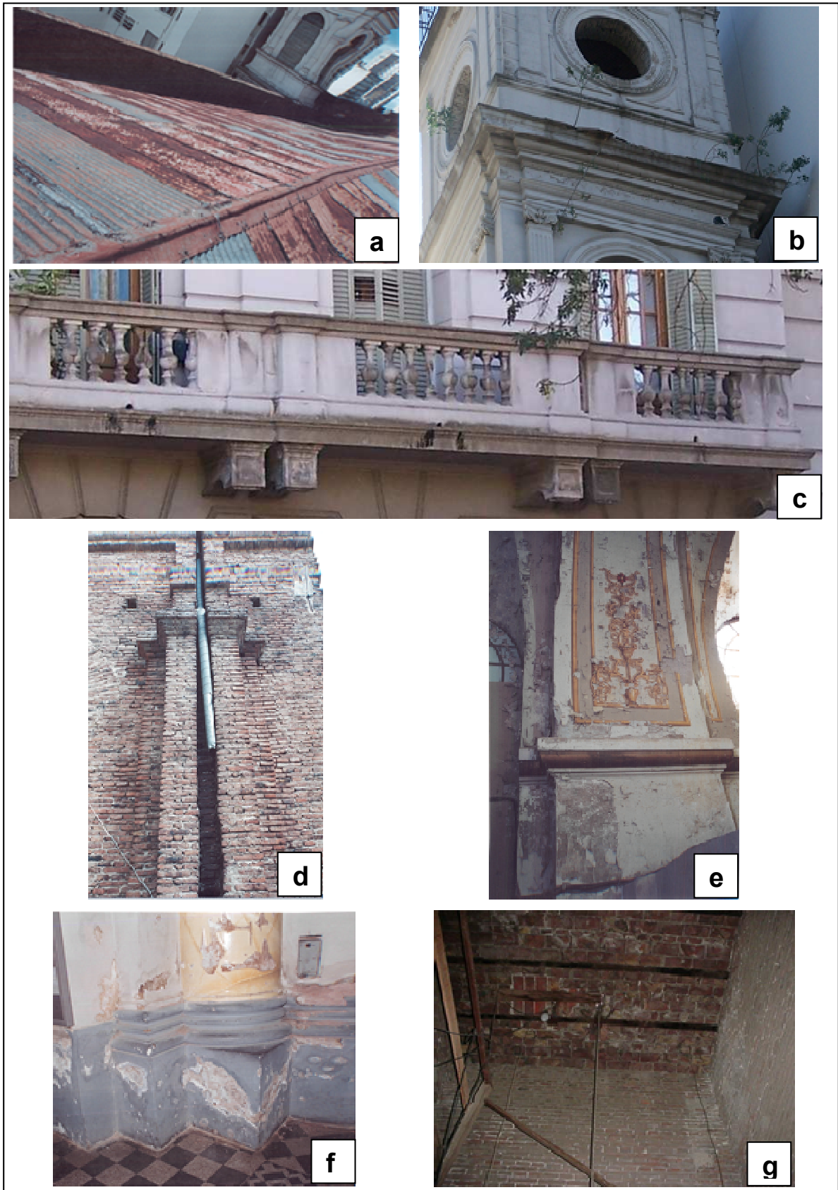
Figura 2: a. Chapas del techo. b. Vegetación crecida en la torre del campanario. c. Balaústres. d. Desagües pluviales. e. Desprendimientos en revoques y molduras. f. Manchas de humedad. g. Losa bajo el campanario.
