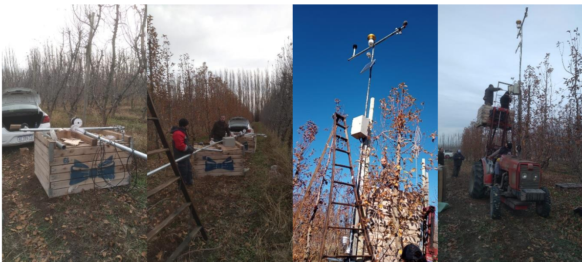
Figura 3. Estructura de hierro galvanizado donde se montaron los sensores.
